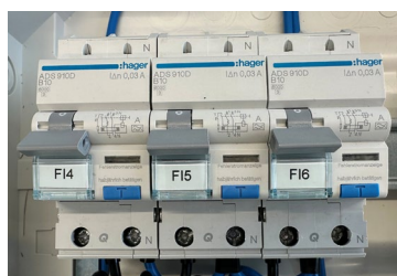
Jištění světelných obvodů
